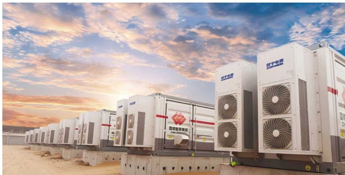
宁夏中卫100MW/200MWh光伏复合储能项目 项目时间: 2023年 项目地点: 宁夏中卫 项目特色: 创新治沙经济, 赋能宁夏绿色低碳发展
