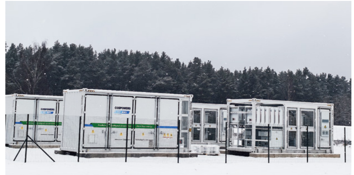
拉脱维亚5MW/10MWh储能系统项目 项目时间: 2025年 项目地点: 拉脱维亚 项目特色: 方案定制化、削峰填谷、辅助服务
