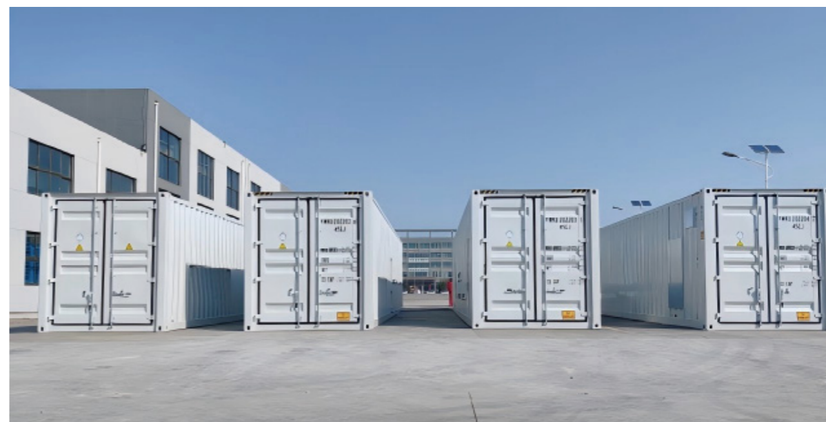
东非光伏发电储能项目 项目时间: 2022年 项目地点: 东非 项目特色: 有效缓解光伏发电的间歇性, 为当地提供稳定、可调的清洁电力
