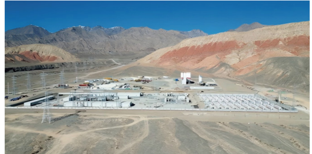
新疆乌恰50MW风能发电50MW/200MWh储能项目
